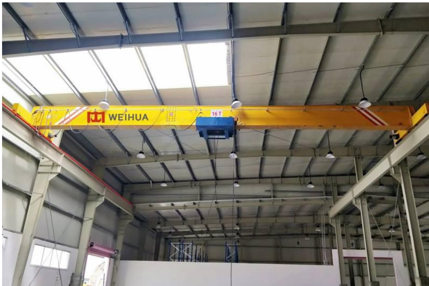
Ponte Rolante de 16 Toneladas
